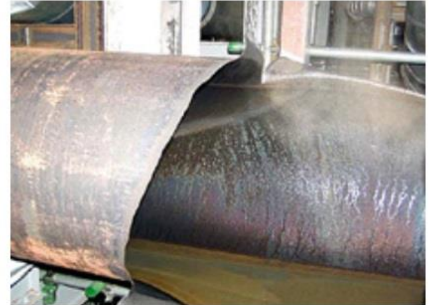
Figure 2 : Vue au niveau de la rupture du tuyau de diamètre 56 cm
