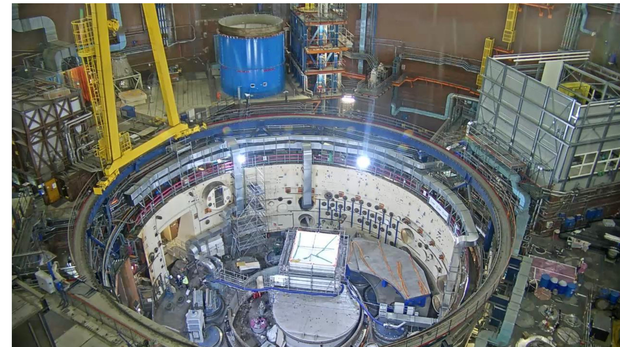
Vue de l'intérieur du bâtiment réacteur en mai 2021. On distingue au centre de la cuve le sas de découpe du dernier bouchon de la cuve ( voir article page 2) ©EDF- Creys
